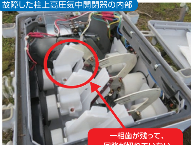
故障した柱上高圧気中開閉器の内部
